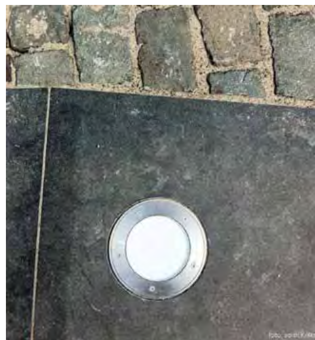
De vier spots markeren de noord-zuidcoördinaten
