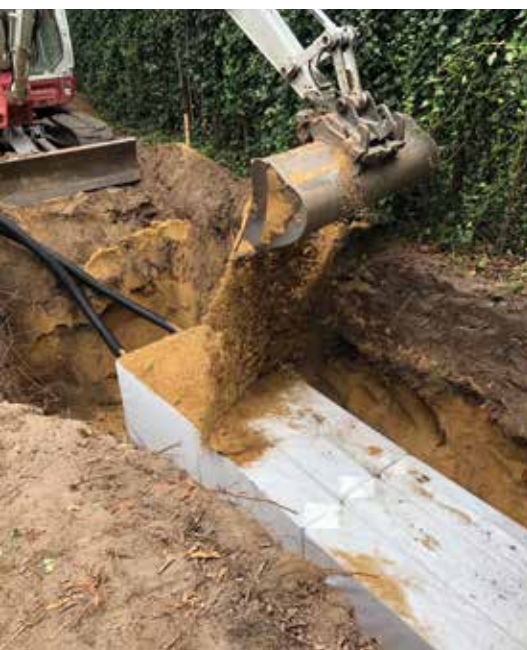
Aanleg infiltratievoorziening uitbouw. Aangelegde capaciteit: 4700 liter. Inhoud infiltratievoorziening: slechts 3060 liter!
