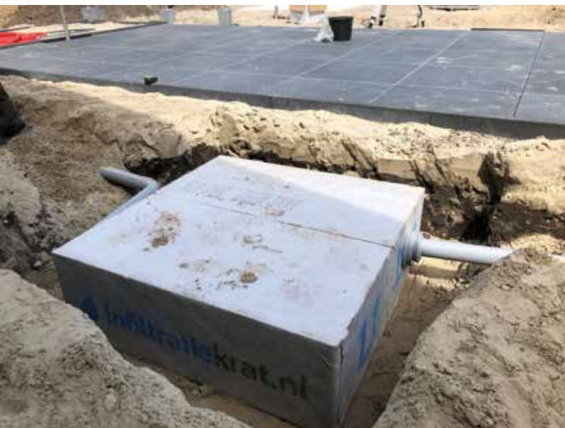
Op meerdere locaties in de tuin zijn infiltratiekratten geplaatst, zodat de omliggende beplanting er zoveel mogelijk profijt van heeft.
