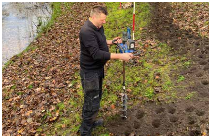
Op een begraafplaats wordt geboord om wortelschade te voorkomen. Hier: Begraafplaats Kleverlaan in Haarlem
