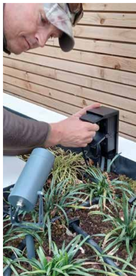
Ook de tuinverlichting is aangesloten op de stroompunten.
